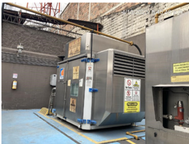
Foto 6. Compresor de gas natural vehicular Fuente: Secretaría de Ambiente
